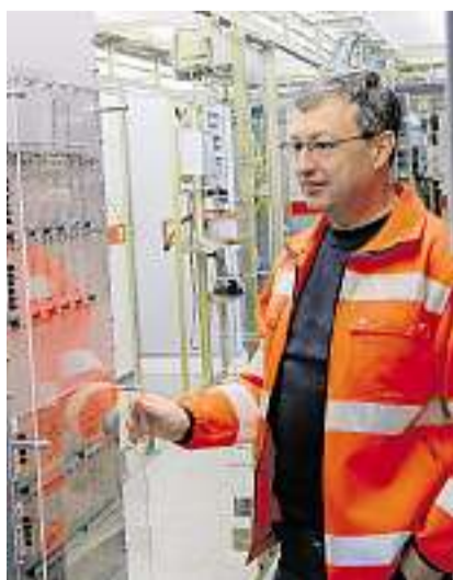
Im Relaisraum: Arno Zehnder, Leiter Sicherungsanlagen der SOB.
